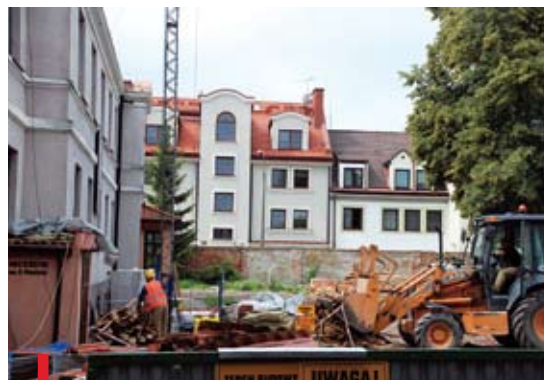
Trwa oczyszczanie terenu, na którym w przyszłości stanie nowe sanktuarium ku czci Bożego Miłosierdzia
